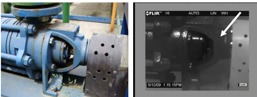
Slika 5. Primjer propuštanja na pumpama agregata
