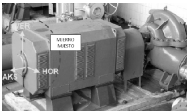
Slika 8. Mjerno mjesto vibracija elektromotora
