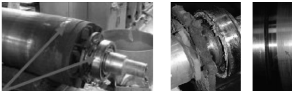
Slika 7. Prikaz oštećenja rotora
