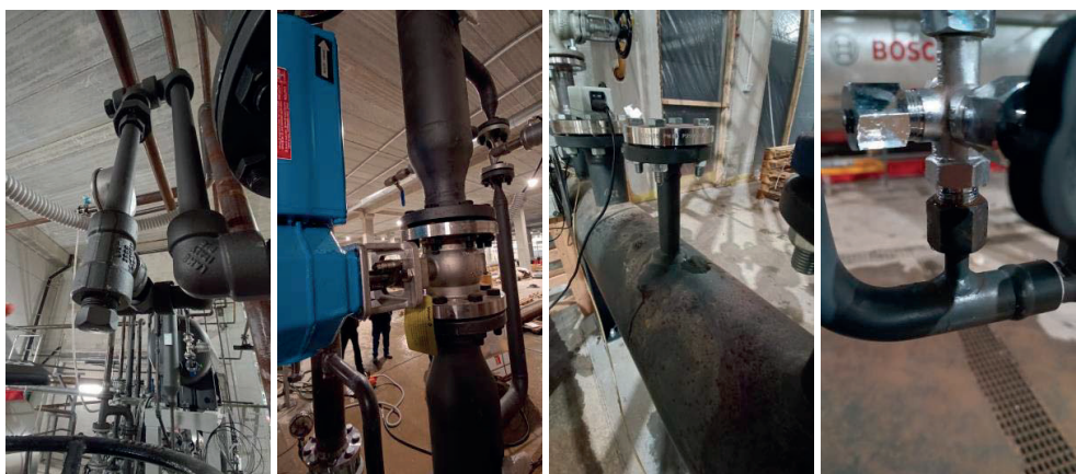
Slika 4. Lokacije na kojima je uočeno kapanje na rastavljivim spojevima
