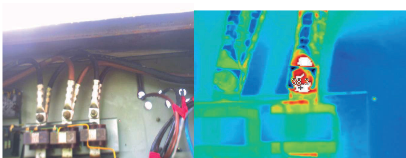
Slika 5. Spoj transformatorskog polja na trećoj fazi ŽSTS 10/0,4 kV Požega
